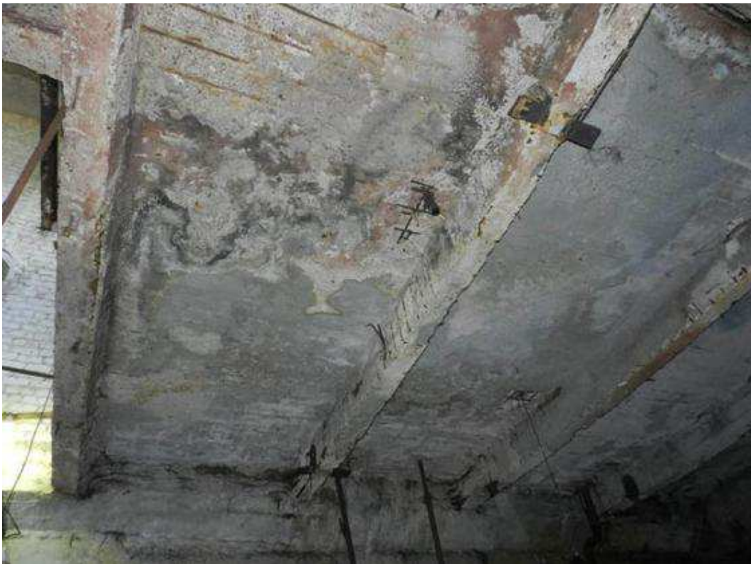
На перегородке между грабельным и машинным отделением наклонные трещины шириной раскрытия до 2мм, разрушение штукатурного слоя перекрытия.
