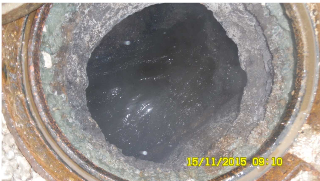
Канализационный колодец КК-п1– Фото 3.
